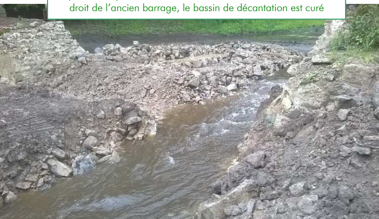
Juin : un dernier abaissement du point bas dans la brèche permet d'optimiser la hauteur du lit du futur cours d'eau au droit de l'ancien barrage, le bassin de décantation est curé
