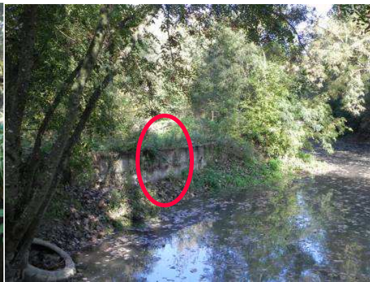
Photo avant travaux Ouvrage à contourner et prise d'eau du bras de contournement (rideau de palplanches à découper).
