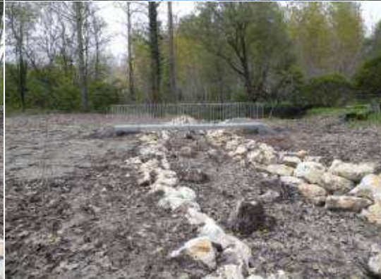
Photo après travaux De l'amont vers l'aval bras de contournement (hors d'eau).
