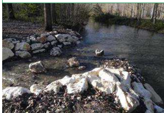
Photo 4 mois après travaux Connexion entre la prise d'eau et le bras de contournement (en eau).
